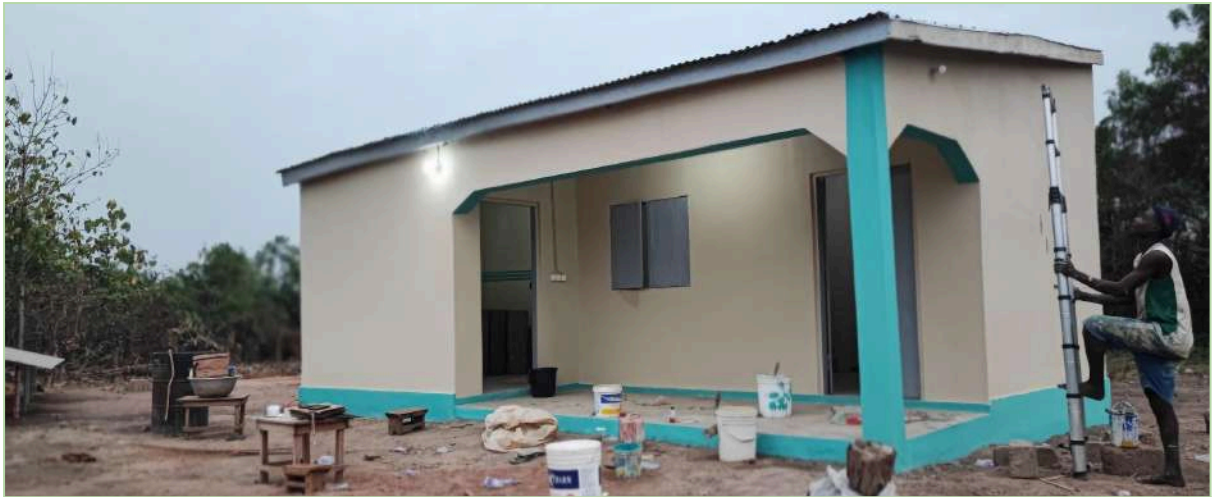
Img. 8 : Bâtiment technique abritant les systèmes productifs
