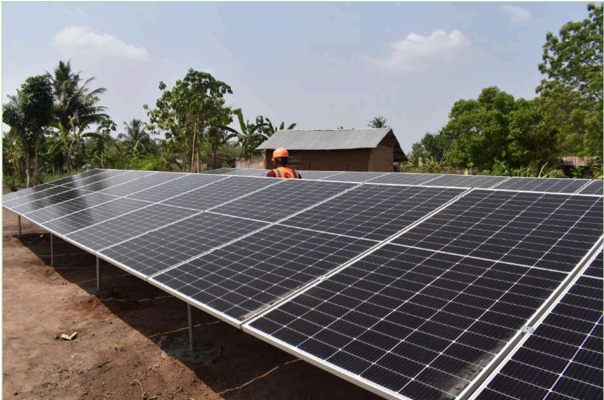
Img. 7 : Panneaux installés sur le site du projet
